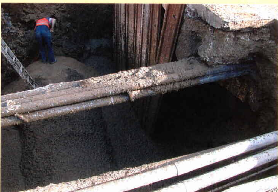
Bild 2: Verfüllung des Kanalgrabens und der Hohlräume im Bereich der Hauptverkehrsstraße und Versorgungsleitungen
