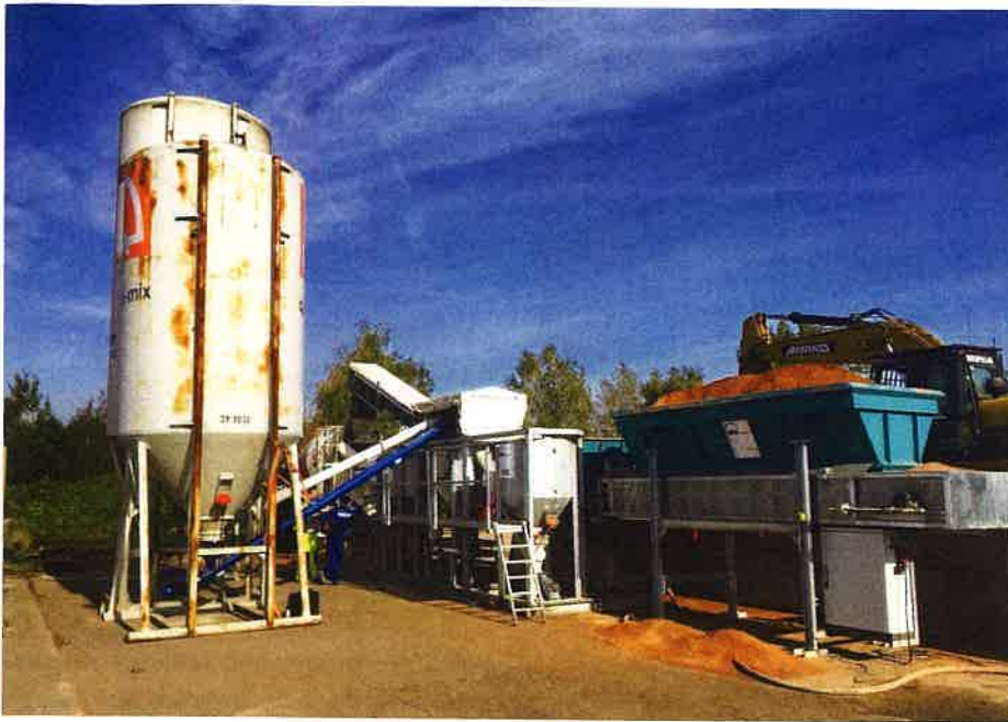
Die RSS-Kompaktanlage auf dem Gelände der Firma Nordmineral im Einsatz. Die Steuerung der Anlage und die richtige Zusammensetzung des Flüssigbodens sind für qualitativen Einbau enorm wichtig. | Fotos: FIFB Leipzig
