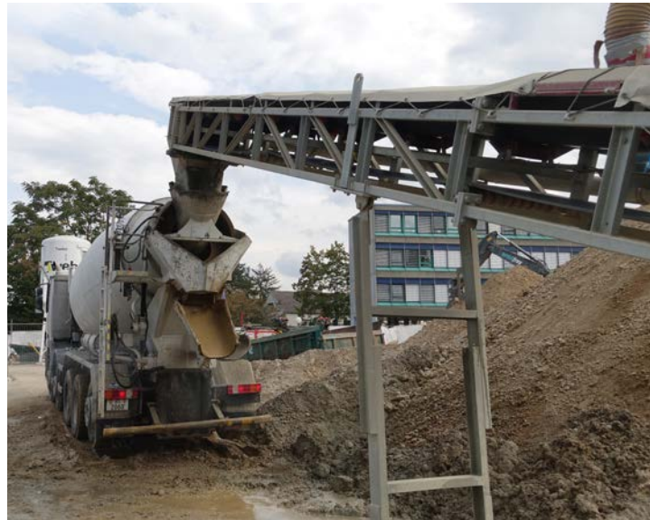
Das Bodenmaterial wird gemeinsam mit Compound und Zement über ein Band in den Drehmischer befördert und dort mit Wasser vermisch.
