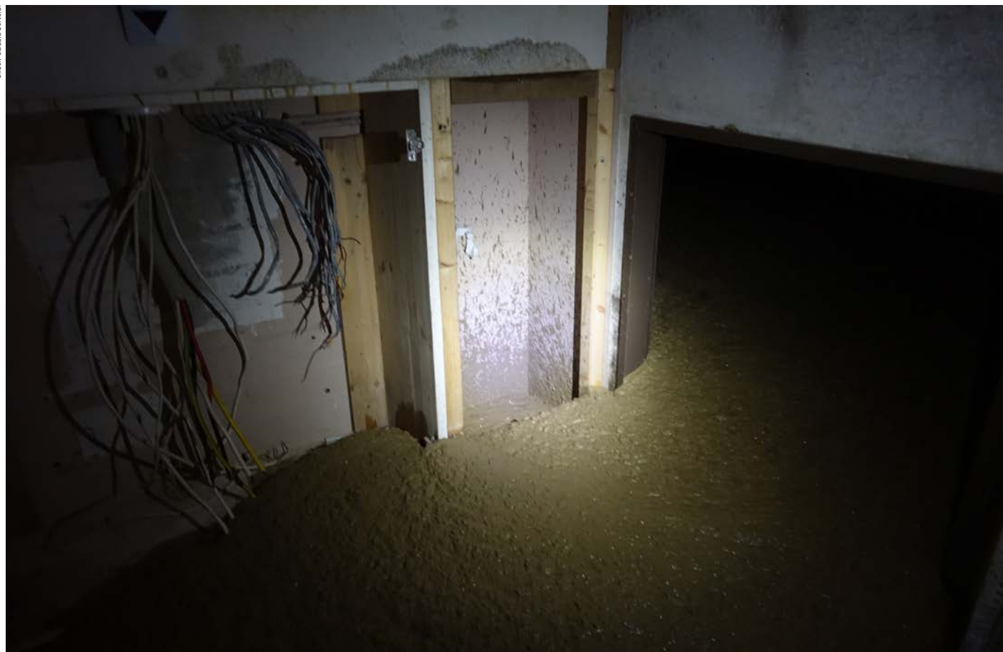
Baustelle Projekt «Muttenz Rennbahn»: das zweite Untergeschoss des ehemaligen Gewerbebaus wird mit RSS-Flüssigboden verfüllt. Die Masse breitet sich gleichmässig aus und nimmt bei der Erhärtung bodenähnliche Eigenschaften an.
