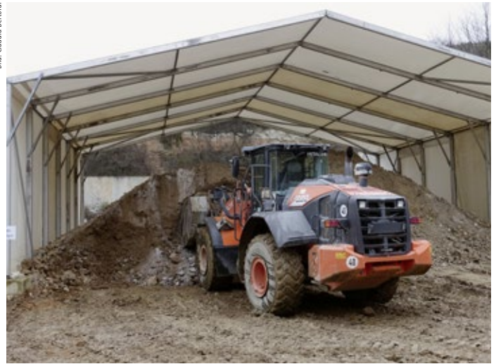
Das Aushubmaterial der Baustelle wird neben der Mischanlage zwischengelagert und dann für die Herstellung des Flüssigboden geladen. Der Schaufelseparator des Radladers hält grobe Bestandteile zurück.
