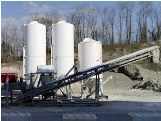
Mischanlage der RSS Flüssigboden Schweiz AG in Stein AG. Die Dosiereinheit wird mit Aushubmaterial befüllt. Compound, Zement und Kalk werden aus den Silos beigegeben.
