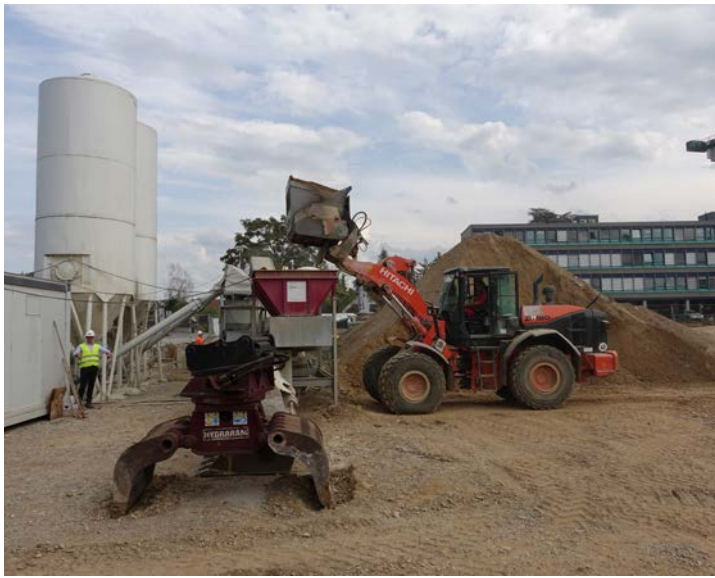
Das Beladung der Mischanlage mit einem Schaufelseparator direkt vor Ort. Das Bodenmaterial stammt aus der dahinter liegenden Baugrube.
